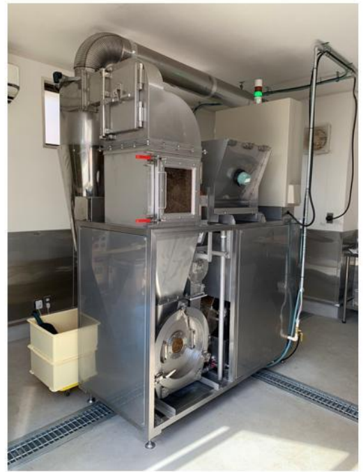
ラボ内に設置された『過熱蒸煎機』
